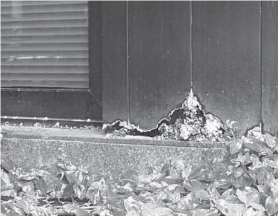
Anodizatutako fatxadaren korrosioa.
